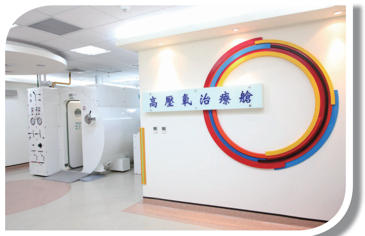
▲臺北榮總高壓氧治療艙設備。
